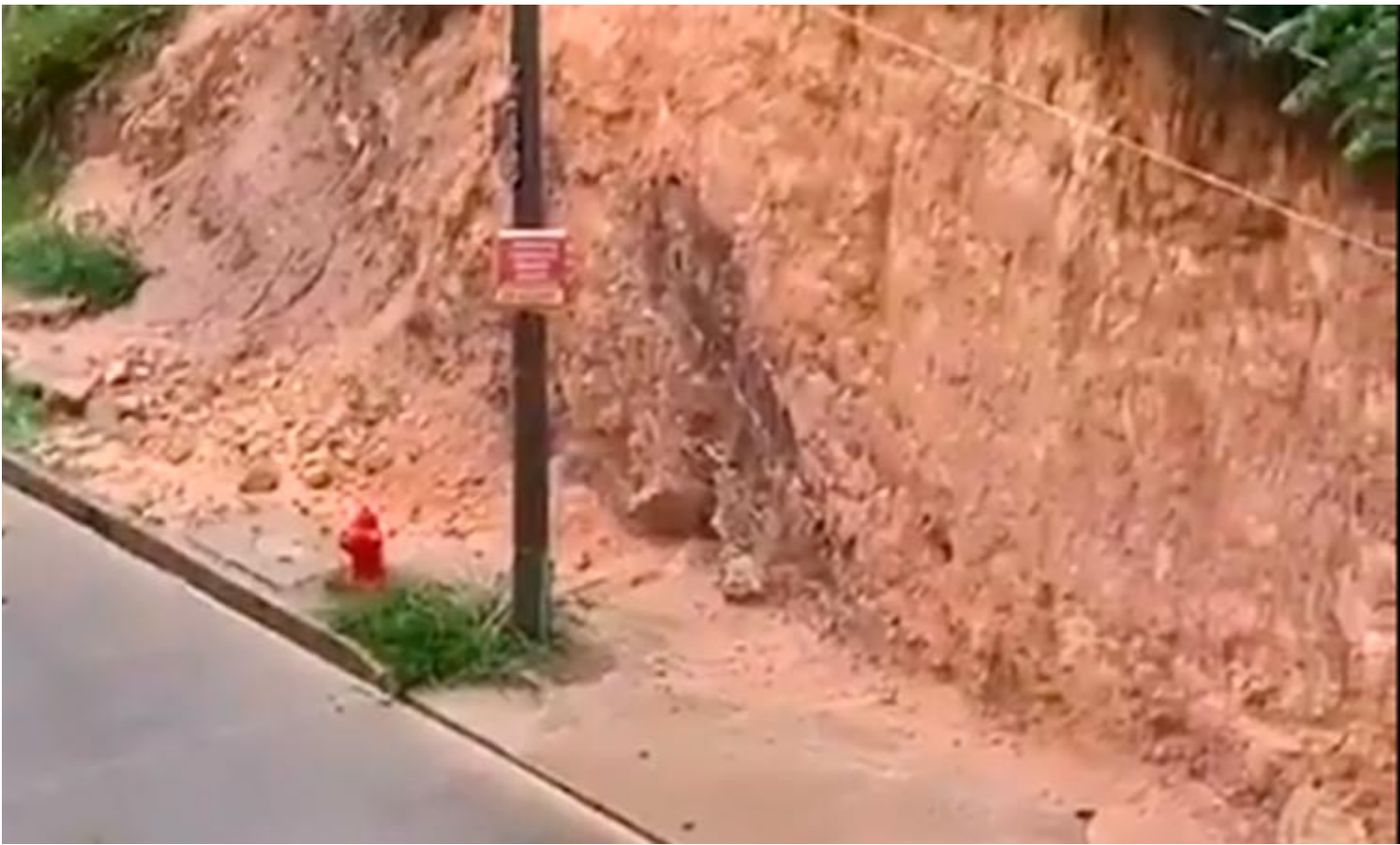
Se presentaron deslizamientos leves en la Avenida de los Cerros Crédito: Tomado de Twitter
